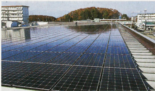
いちい蓬萊店の屋根に設置された太陽光パネル
